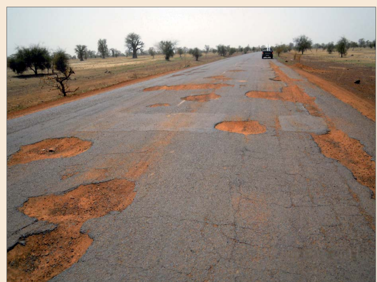
Surcharge et dégradation accélérée des routes
